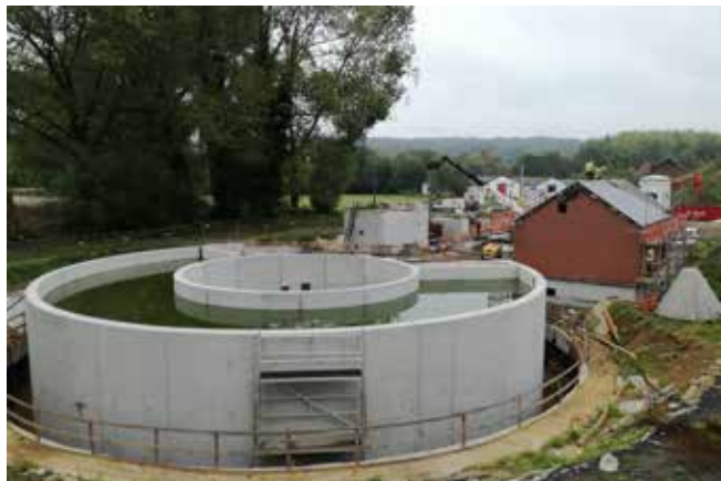
STEP Oisquerq ouvrage combiné
