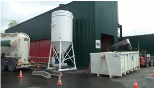
Unité de post chaulage en phase de remplissage
