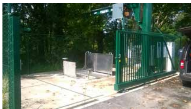
Nouvelle station de pompage mise en service en 2017 (Incourt Namur)
