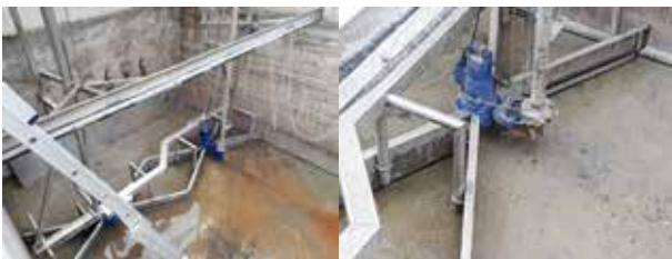
Placement des sondes dans le bassin biologique de la station d'épuration de Rebecq Bierghes
