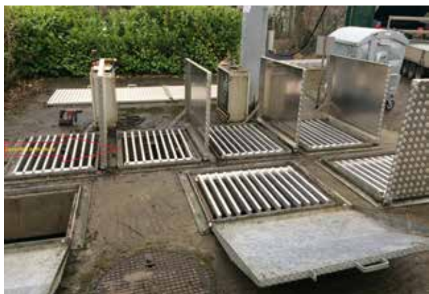
Equipements standardisés: extérieur d'une station de pompage
