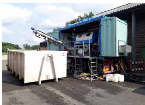
Presses à boues
