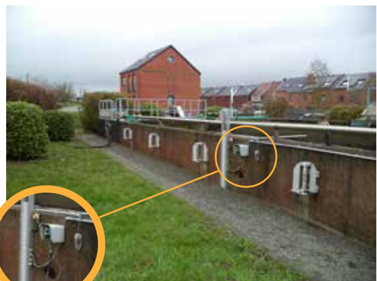
Ecran de la sonde MES placée dans le bassin biologique de la station d'épuration de Rebecq Bierghes
