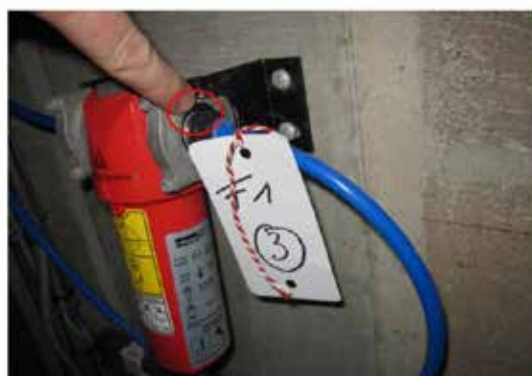
Bâtiment B1 Local Vidangeur : Fuite au niveau du raccord entre le flexible bleu et le filtre à côté de la vanne 181VA1600.
