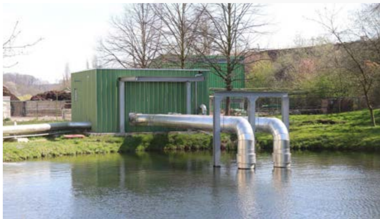
Local pomperie et chambre de pompage
